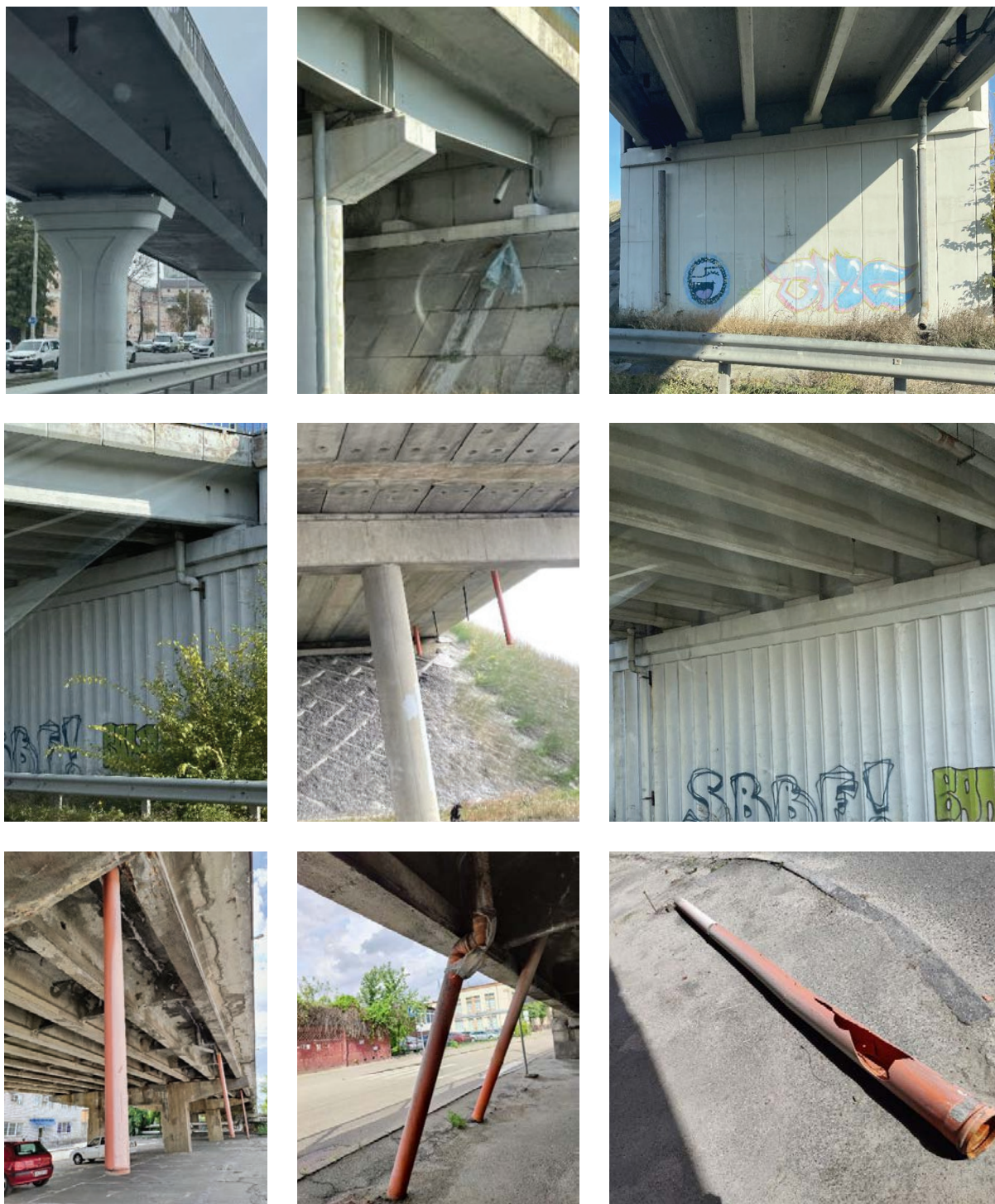
Рисунок 1 – Застосування каналізаційних та водопровідних трубопроводів для водовідводу з штучних споруд та їх деформації
